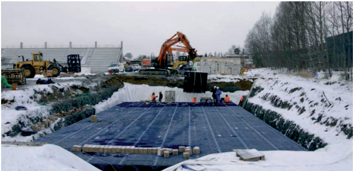
Bildet viser et Q-Bic anlegg på Sandefjord stadion
