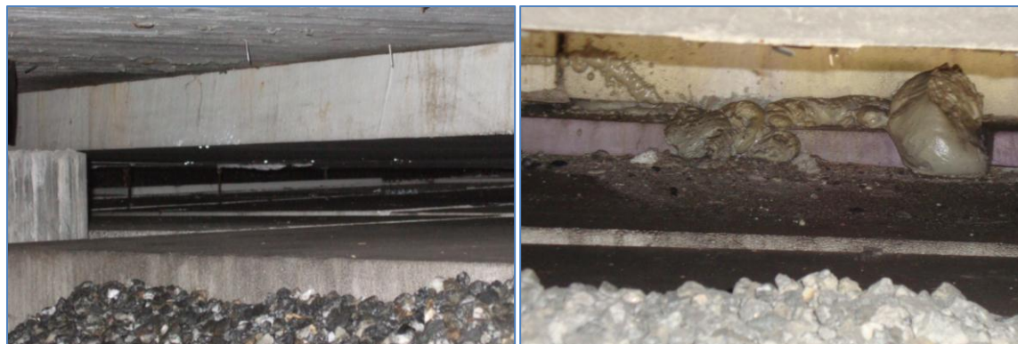
Figur 3.6 T.v.: Setningsskader i Skulleruddumpa på E6 sør i Oslo. Det øverste EPS-laget henger igjen i taket, etter at resten av fyllingen har satt seg (A. G. Olsen, 2008). T.h.: Tomrommet er fylt opp igjen med XPS-plater Uretek-resin (S. Hermansen, 2012).
