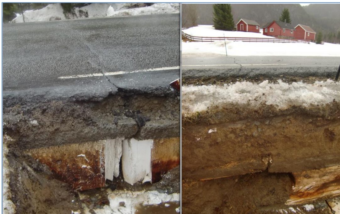
Figur 11.11 Brudd i betongdekket sett fra hhv. øst- og vestsiden. Fra myrbroen på fv.610 (S. Hermansen, 2012).
