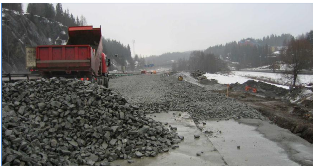
Figur 4.8 Legging av forsterkningslag, komprimeres med vegvals eller vibratorplate. På grunn av betongoverdekning på 10 cm kan forsterkningslaget reduseres med 20 cm (Ref. 20).
