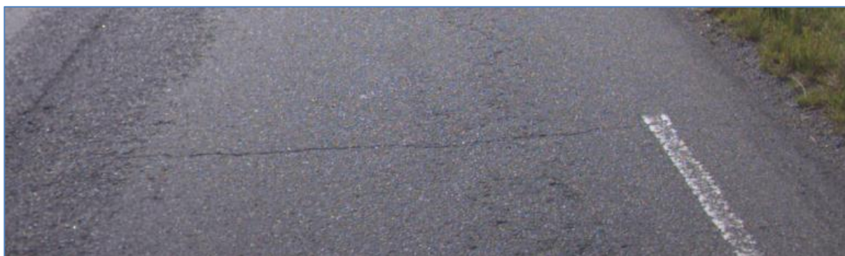
Figur 11.15 Søndre tverrgående sprekke (ViaPhoto, 2008).
