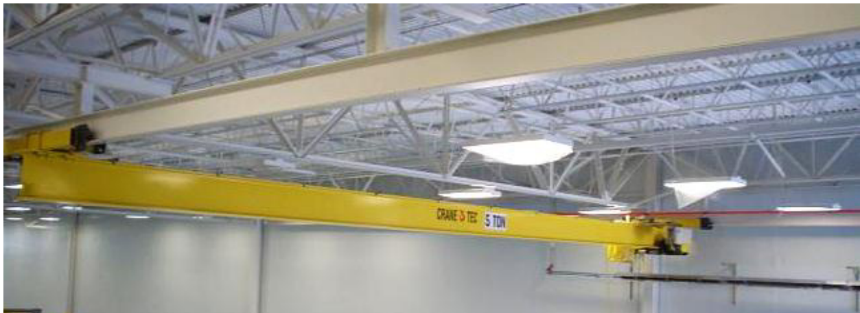
Figur 5: Bilde av en underhengende løpekran fra Crane Tec. (19) Det vises at kranbrua består av én drager og at bruvognene henger på kranbanebjelkenes nederste flens. Bildet antyder at denne kranen har en maksimalt tillatt last på 5 tonn.
