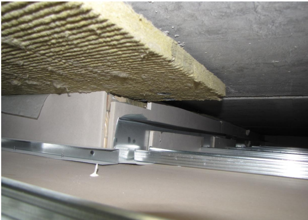
Figur 3.11: Bildet er tatt over himling, og viser hjørneløsning i yttervegg hvor det er utett i brannisolasjonssjiktet mellom dampsperre og hulldekke.
