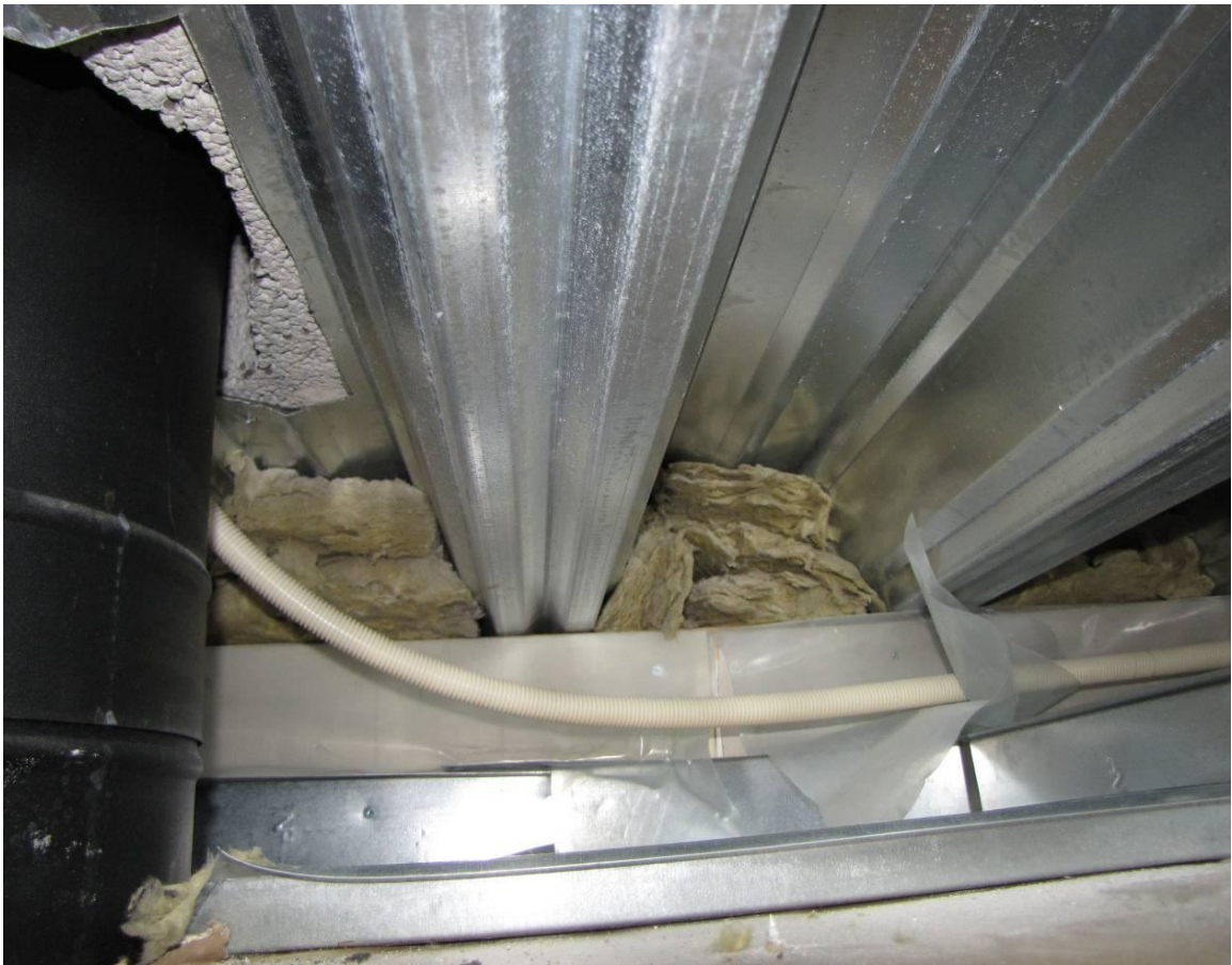
Figur 3.2: Overgang mellom yttervegg og TRP plater med manglende lufttetting.
