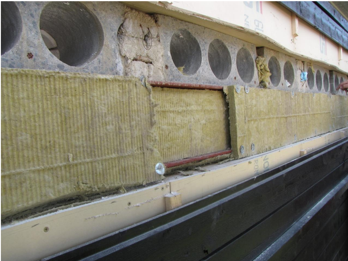
Figur 3.12: Åpning av fasade hvor åpningene i hulldekkene ikke er tett, og det er utett i brannisolasjonssjikt under stålet.
