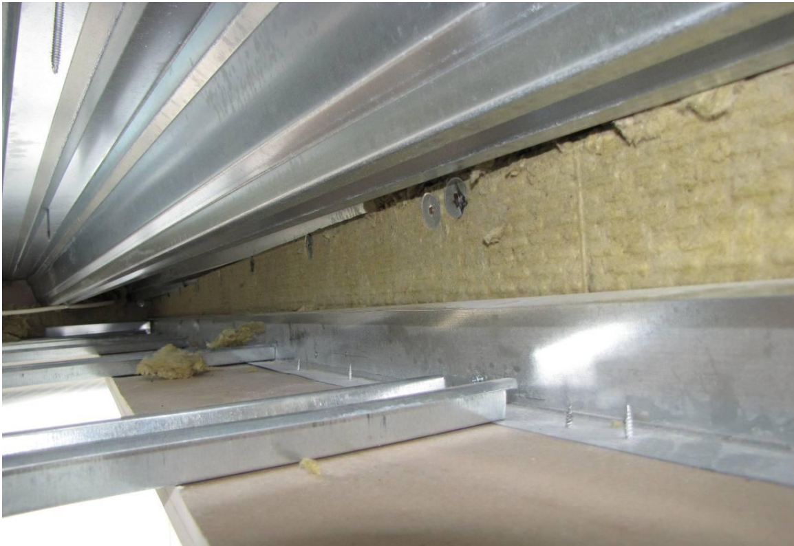
Figur 3.4: Overgang fra brannisolert stålbæring til TRP-plate med manglende lufttetting. Dette er utbedret med gips og fuging.
