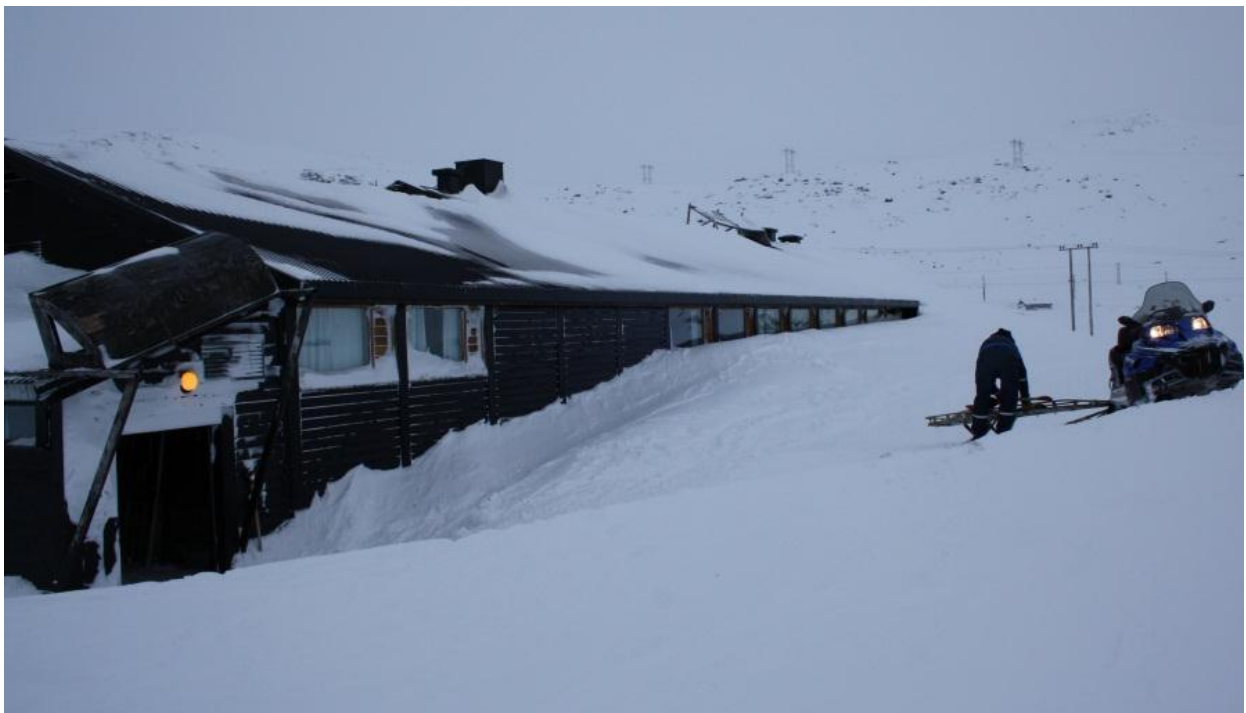
Figur 19: Lesiden av samme bygning som over. Lengst bort på taket strekker fonnen seg fra mønet og ned på bakken. Legg forøvrig merke til «spylehatten» til venstre i bildet som ved hjelp av vinden fjerner snøen i lesonen ved porten.
