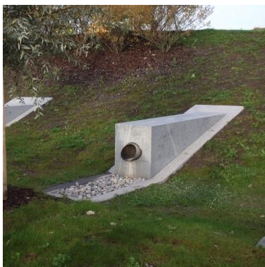
FIGUR 24: OVERFLATEVANN FRA RØR
