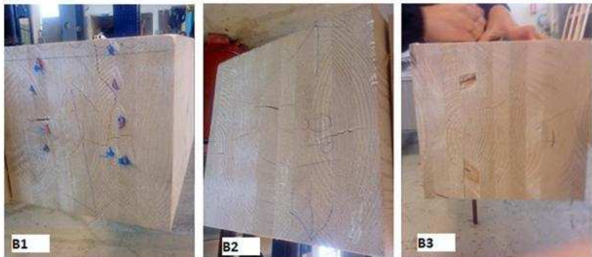
Figur 6.2 Oppsprekking ytterst på trevirket
