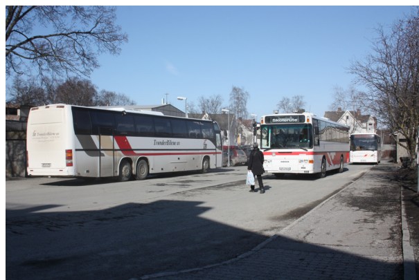
Figur 3.33: Dårlig belegg på bussholdeplassen.
