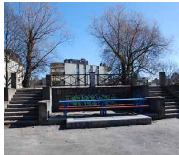
Bilde 42: Trappesystem opp mot kolle på Nordahl Rolfsens plass. Anlegget preges av slitasje.
