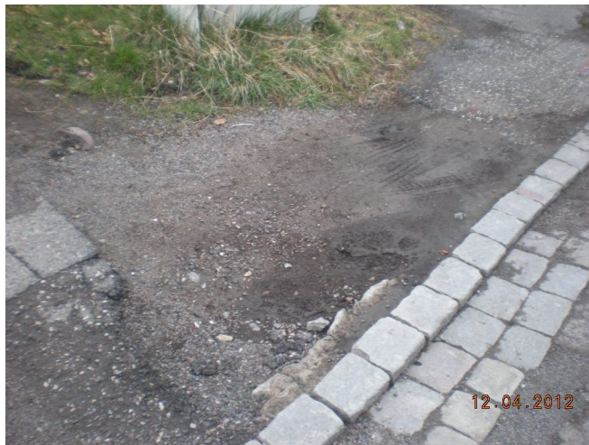
Bilde 34 skolevei 1 Træleborg. Viser hull i fortauet.
