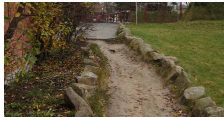
Et bilde av den dårlige opparbeidede grusatkomsten i vest.
