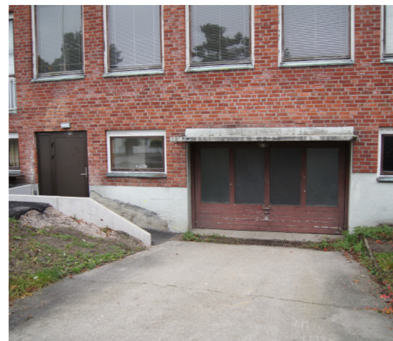
Bildet viser helningen ned mot vareleveringsporten til kjelleren, sløydhallen og skolekjøkkenet. Denne blir sjeldent brukt, men er nødvendig til leveranser av ulike materialer og matvarer skolekjøkkenet.
