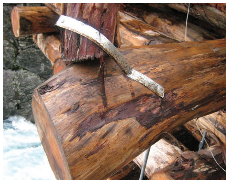
Fig. 3 Bildet viser del av en mislykket tilbakeført bru der det er brukt moderne materialer.
