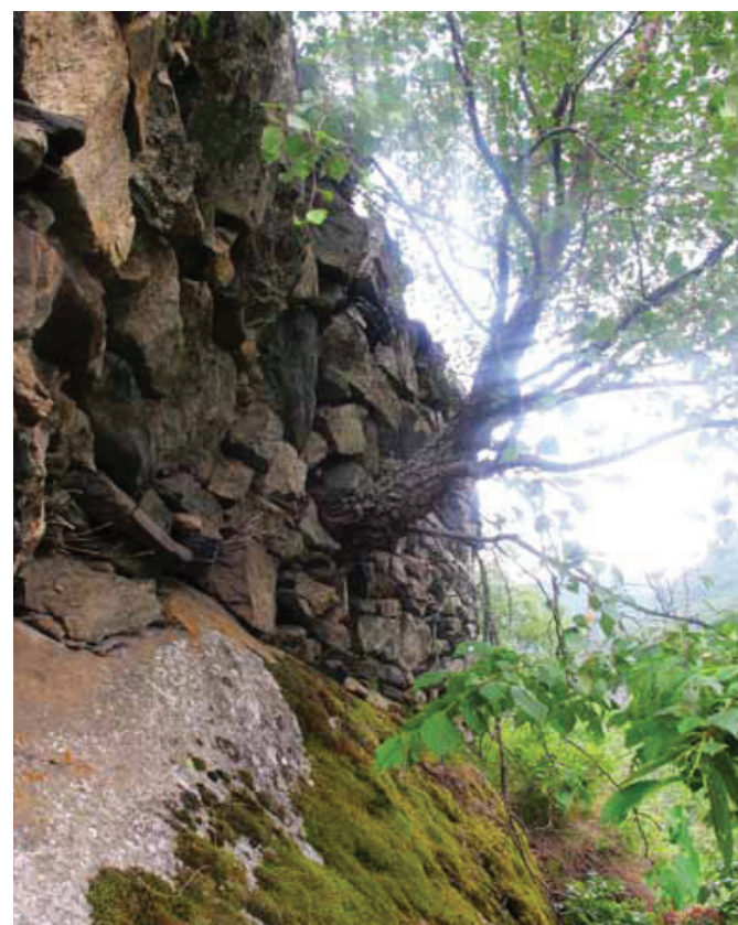
Fig. 21 Trær som vokser i vegmuren er et stort problem.
