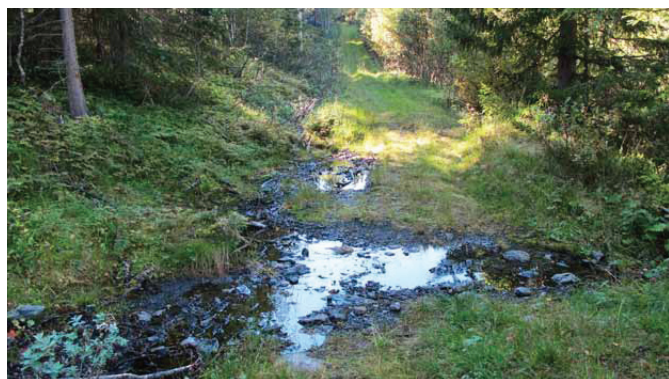
Fig. 19 Bildet viser eksempel på hva som skjer når stikkrenna tettes. Vannet går over vegen isteden.
