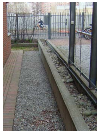
Bilde 101: Sedum som skulle være i den ene passasjen mangler.
