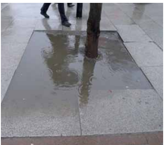
Grunnen i byer er ofte kompakt og presset hardt sammen. Dette treet står i et jordsmonn som er tett pakket. Overvannet blir stående og infiltrerer ikke godt ned i jorda.
