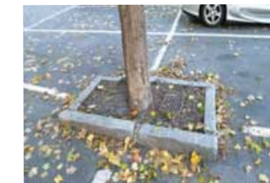
Trærnes vekstforhold ved Frognerparkens parkeringsarealer er ikke ideell. Kantstein ligger tett inntil treet's stamme og begrenser vanntilgangen til treet. Kantsteinens plassering er trolig utformet på denne måten for å beskytte treet mot skader fra brøytemaskiner.
