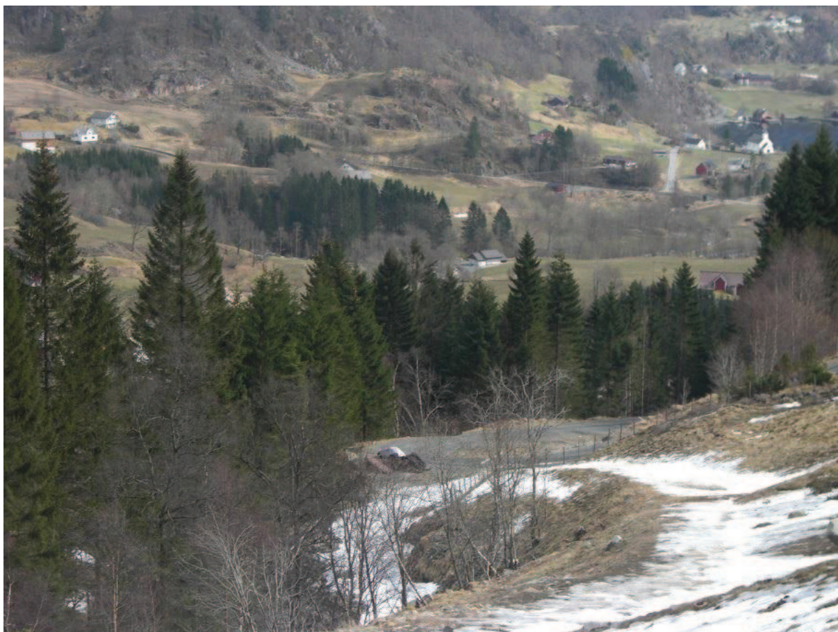
Figur 10 syner i framkant røyrgata som er grave ned. Midt i biletet kan ein sjå kraftstasjonen plassert nedst på innmarka, (eige foto).
