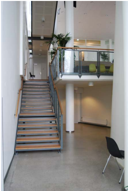
Figur 6. Trapp opp til amfiet og administrasjonen. Mangler fare- og oppmerksomhetsfelt, samt kontraststriper. Ikke avrundede håndlister.
