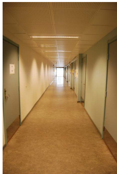
Figur 20. Bred korridor uten hindringer. Dørene er i kontrast til veggene. Minus for blending i enden.
