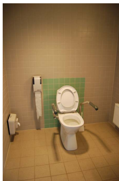
Figur 18. Handikaptaolett. Dårlig kontrast mellom vegg og gulv, men bra med kontrastfarge bak toalettet. Minus for høy terskel inn.
