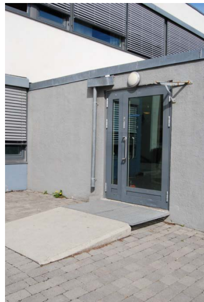
Figur 16. Inngangspartiet til en av basene. Rampen har ikke rekkverk og hvilereposet er for lite. Høy terskel inn til garderoben.
