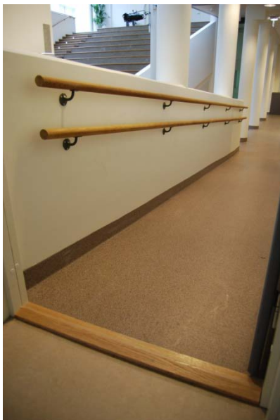
Figur 10. Rampe inn til musikkavdeling. Det mangler hvilerepos, samt at terskelen er for høy (3 cm). Positivt med håndlist i to høyder.
