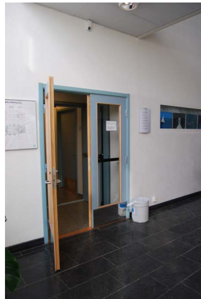
Figur 22. Dør inn til resepsjonen. Terskelen er cirka 4 cm. Kunne vært skiltet bedre. (Skilt på veggen til høyre for døra).
