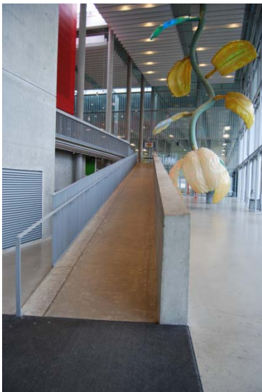
Figur 32. Rampen opp til kantineområdet. Den er bratt og har bare håndlist på en side.
