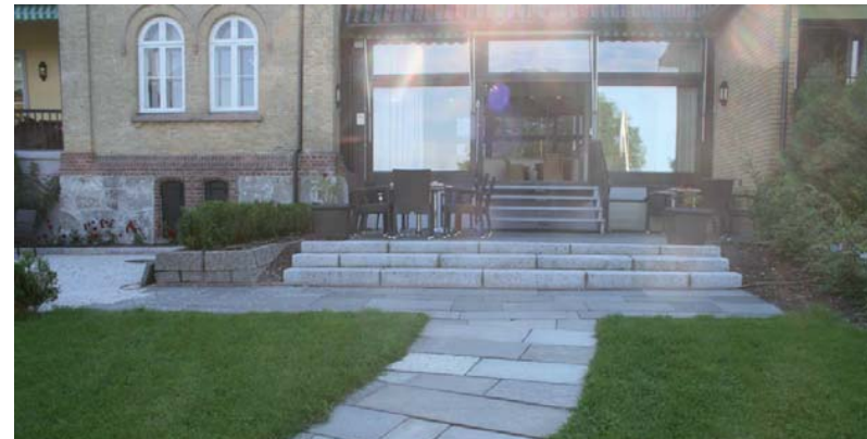
5. Uheldig terrengforskjell på terrassen i vest.
