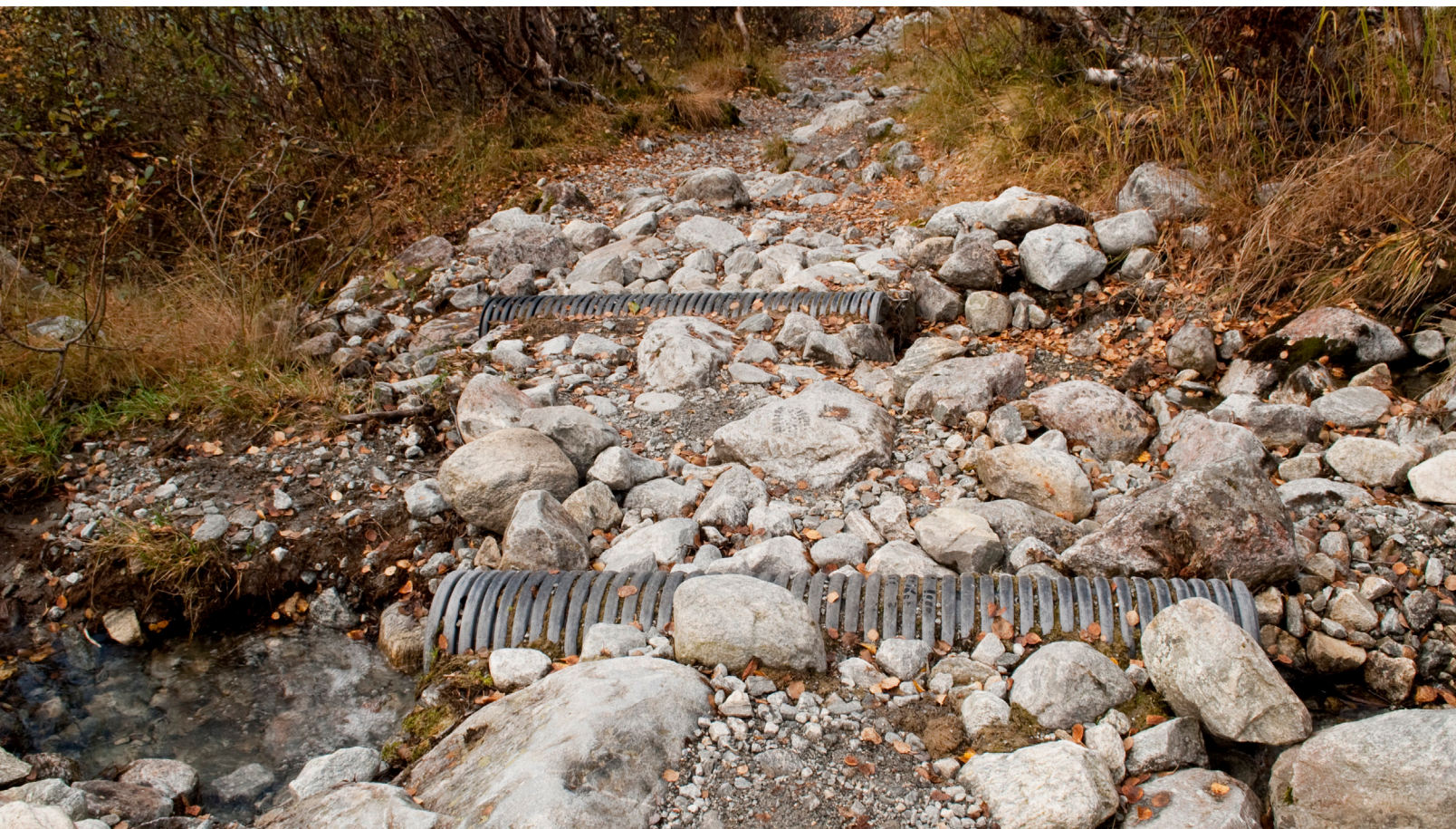
Store rør for å leie vatn.
